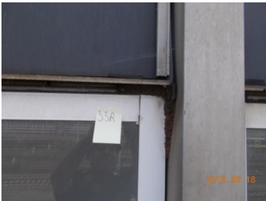
Zdjęcie Nr 125 - brak łączników w listwie fasadowej; listwa podpierająca szybę wklejona na piankę montażową - I p.
