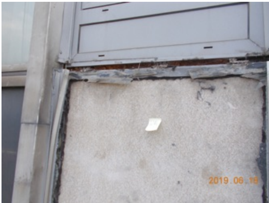
Zdjęcie Nr 121, 124 - brak szyby, pozostałe w profilach fragmenty szkła świadczą, że została stłuczona, brak szczelności fasady - III p.
