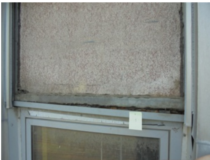
Zdjęcie Nr 50 - szyba wysunęła się z profili mocujących, brak szyby - IV p.
