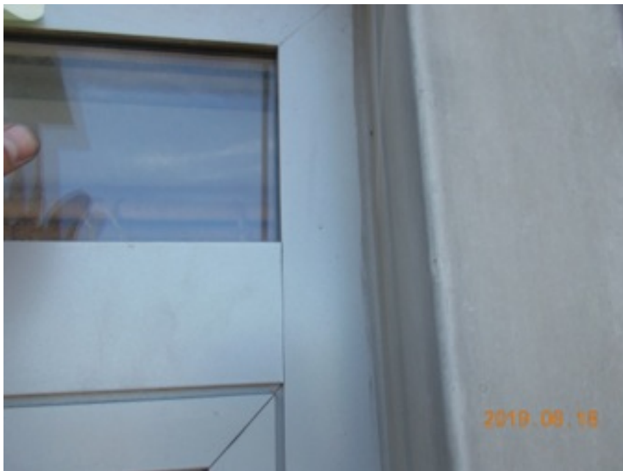
Zdjęcie Nr 64, 65 - brak łączników w listwie fasadowej; listwa podpierająca szybę wygląda na wklejoną; brak systemowych obróbek blacharskich zamykających elewację - VII p.
