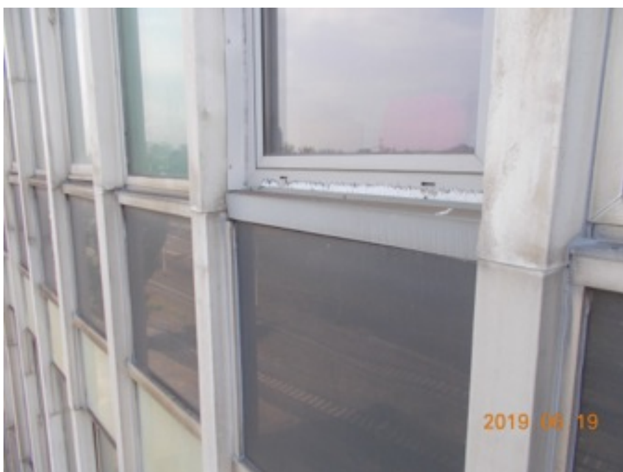
Zdjęcie Nr 154 - z profili okiennych nie zdemontowano taśm zabezpieczających - IV p.
