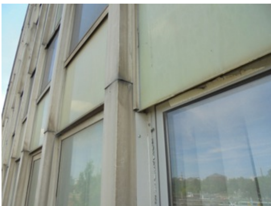
Zdjęcie Nr 23, 24, 25, 26 - dyslokacja szyby nieprzeźiernej wraz z listwami mocującymi, z profili okiennych nie zdemontowano taśm zabezpieczających - III p.
