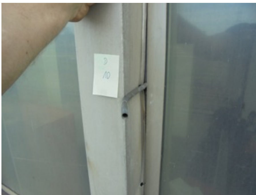
Zdjęcie Nr 40 - pozostałości po instalacji - I p.
