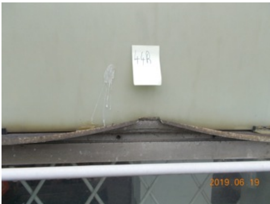
Zdjęcie Nr 148 - uszkodzony profil podpierający szybę - I p.
