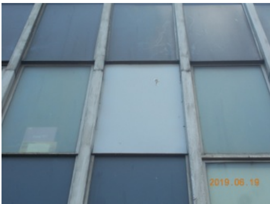
Zdjęcie Nr 162 - w miejsce szyby wstawiono maskownicę z płyty - I p.
