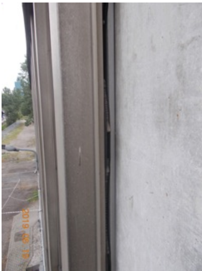
Zdjęcie 134-138-139 - brak szyby pozostałe w profilach fragmenty szkła świadczą, że została stłuczona, brak szczelności fasady - II p.
