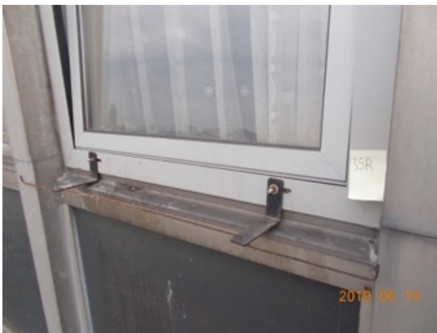
Zdjęcie Nr 127 - w otworach odwadniających zamontowano kątowniki, elementy mogą odpaść od elewacji - VII p.
