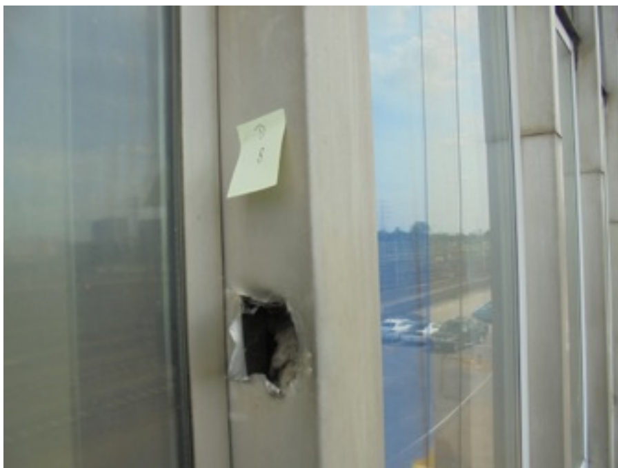
Zdjęcie Nr 38 - uszkodzona maskownica słupa - I p.
