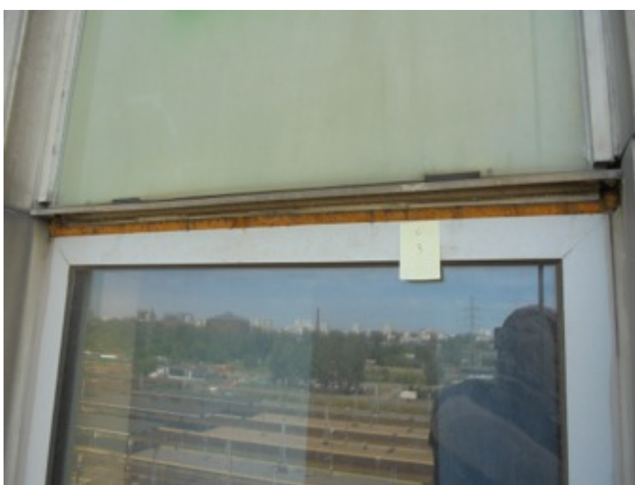
Zdjęcie Nr 15,16 - brak łączników w listwie fasadowej; listwa wspiera się na wkręcie przymocowanym do słupa fasady, brak obróbek po wymianie okna - VI p.
