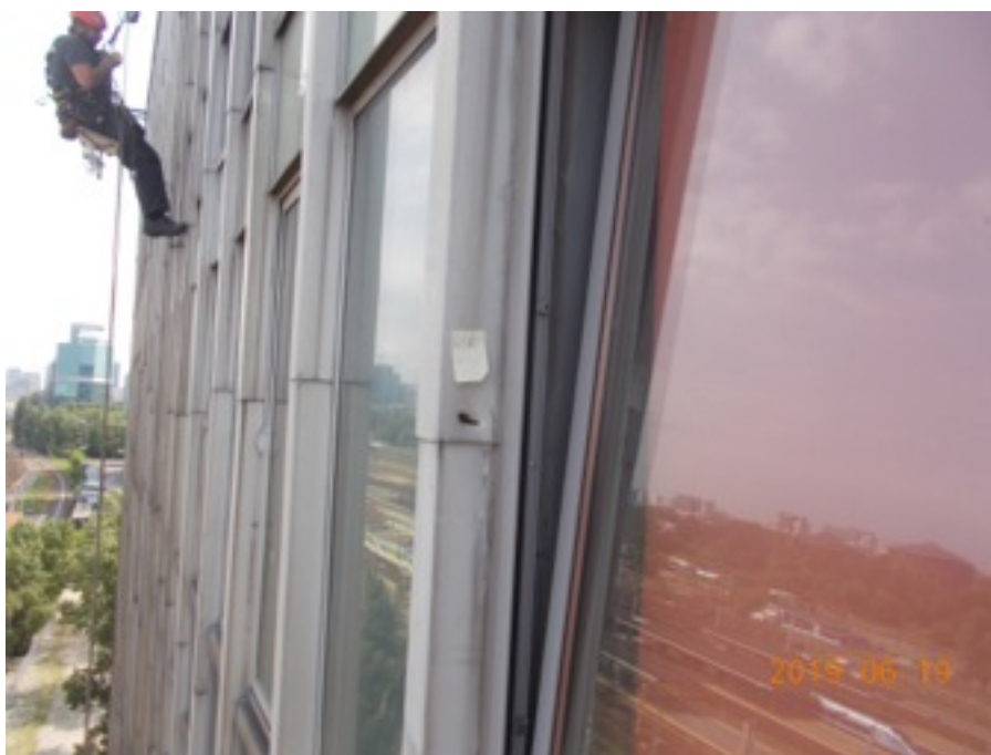
Zdjęcie Nr 150 - uszkodzony profil maskujący na słupie fasady - VIII p.
