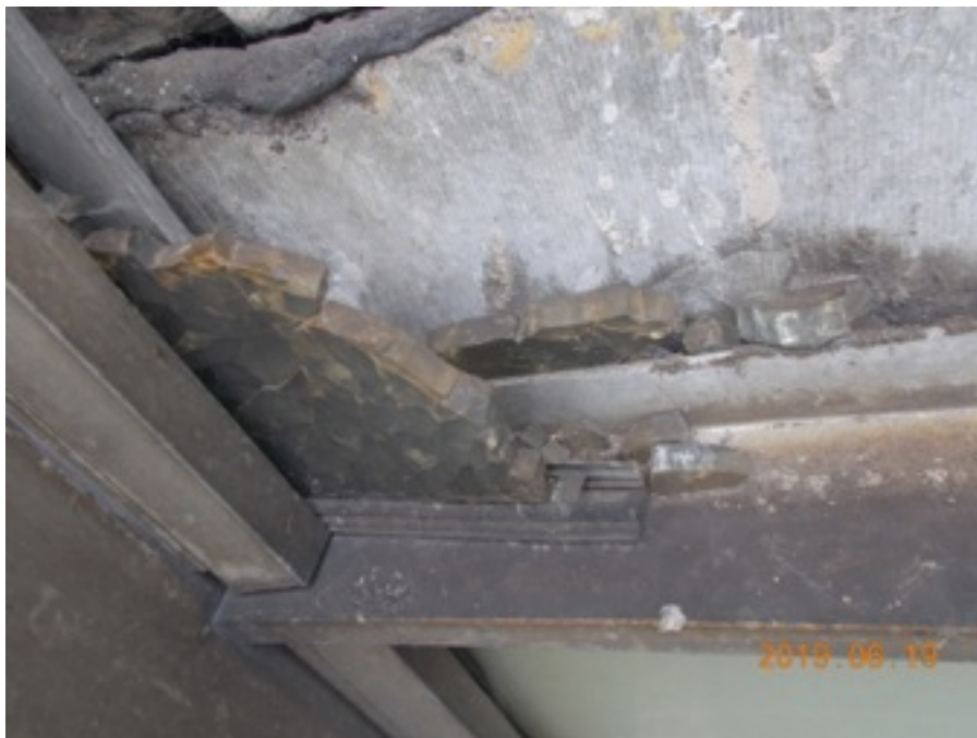
Zdjęcie Nr 144 - 147 - brak szyby, pozostałe w profilach fragmenty szkła świadczą, że została stłuczona - I p.
