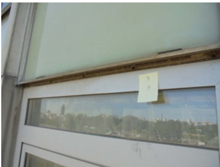
Zdjęcie Nr 9,10 - brak łączników w listwie fasadowej; listwa wspiera się na wkręcie przymocowanym do słupa fasady - V p.
