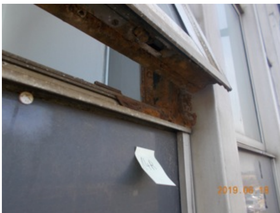
Zdjęcie Nr 95, 96 - skrzydło okienne na styku z ościeżnicą sklejone pianką montażową - I p.
