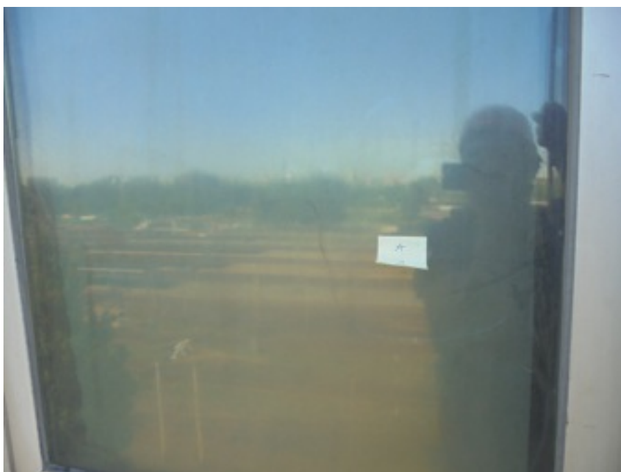
Zdjęcie Nr 1 - pęknięta szyba - VIII p.
