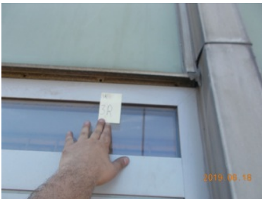
Zdjęcie Nr 66 - brak łączników w listwie fasadowej; listwa podpierająca szybę podklejona na styku ze słupem - IV p.
