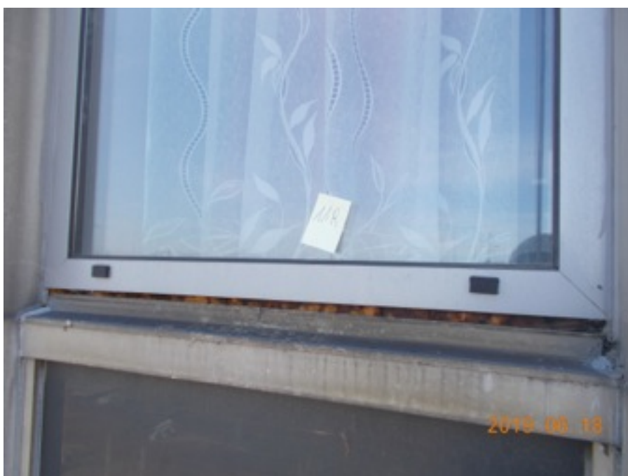
Zdjęcie Nr 82, 83, 84 - brak podparcia szyby nieprzeziernej, dyslokacja profilu podpierającego szybę, brak systemowych obróbek blacharskich zamykających fasadę, brak ciągłości fugi - V p.
