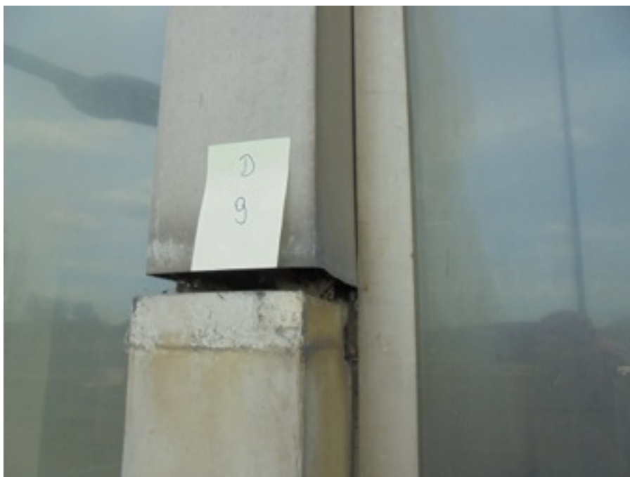
Zdjęcie Nr 39 - brak ciągłości maskownicy słupa - I p.
