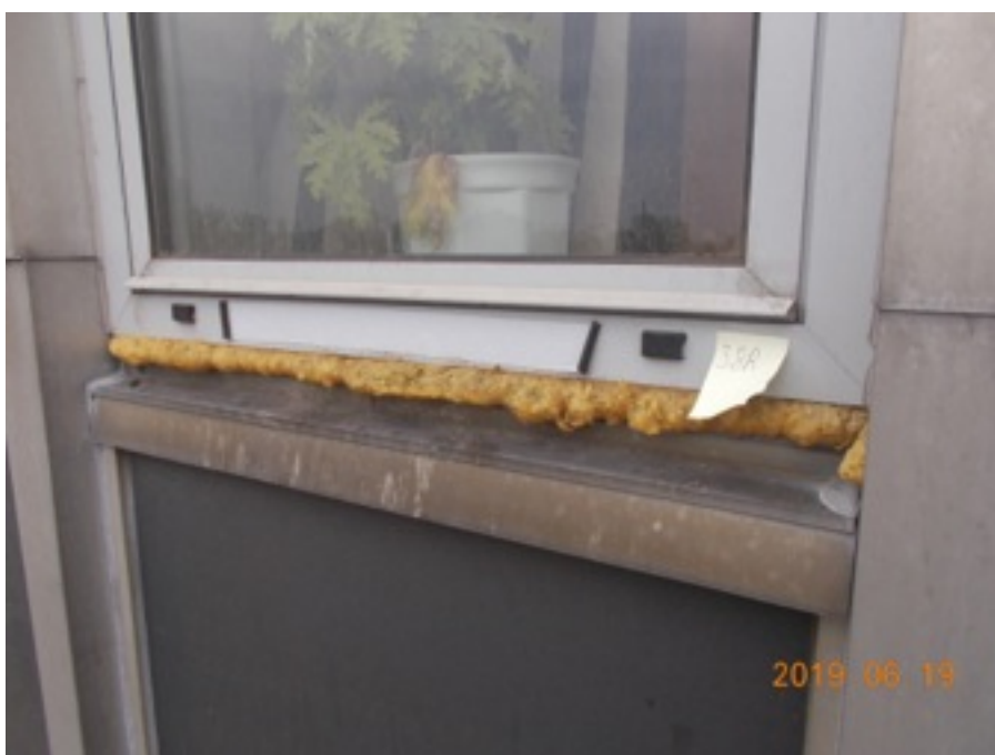
Zdjęcie Nr 131 - brak systemowych obróbek, nie zdjęta taśma zabezpieczająca - IV p.
