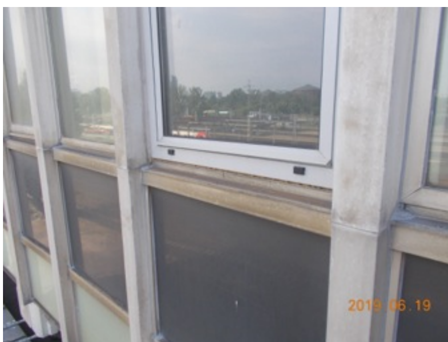
Zdjęcie Nr 155, 156 - profil podpierający szybę nieprzezierną zamocowany na piankę montażową, brak systemowych obróbek blacharskich - III p.
