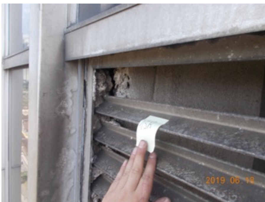
Zdjęcie Nr 97, 98 - ogromne ilości zalegających odchodów ptasich, brak lameli - IX p.
