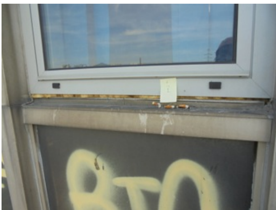
Zdjęcie Nr 12, 13, 14 - brak łączników w listwie fasadowej; listwa wspiera się na wkręcie przymocowanym do słupa fasady, brak obróbek po wymianie okna - VII p.
