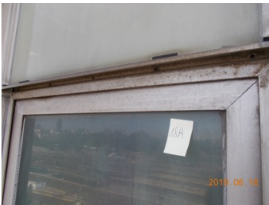
Zdjęcie Nr 102 - brak ciągłości kitu przy szybie w ramie skrzydła okiennego - VI p.
