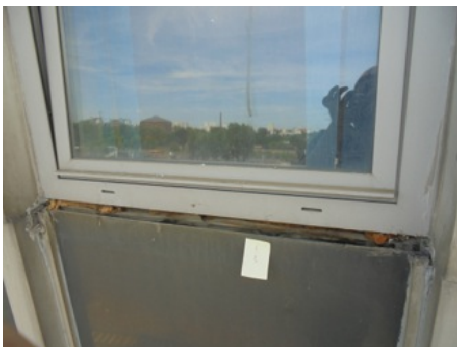
Zdjęcie Nr 17, 18, 19, 20 - listwa pod szybą nieprzezierną odkształcona i poluzowana, brak łączników; brak szczelności na połączeniu ze słupem; brak profilu pod-parapetowego - V p.
