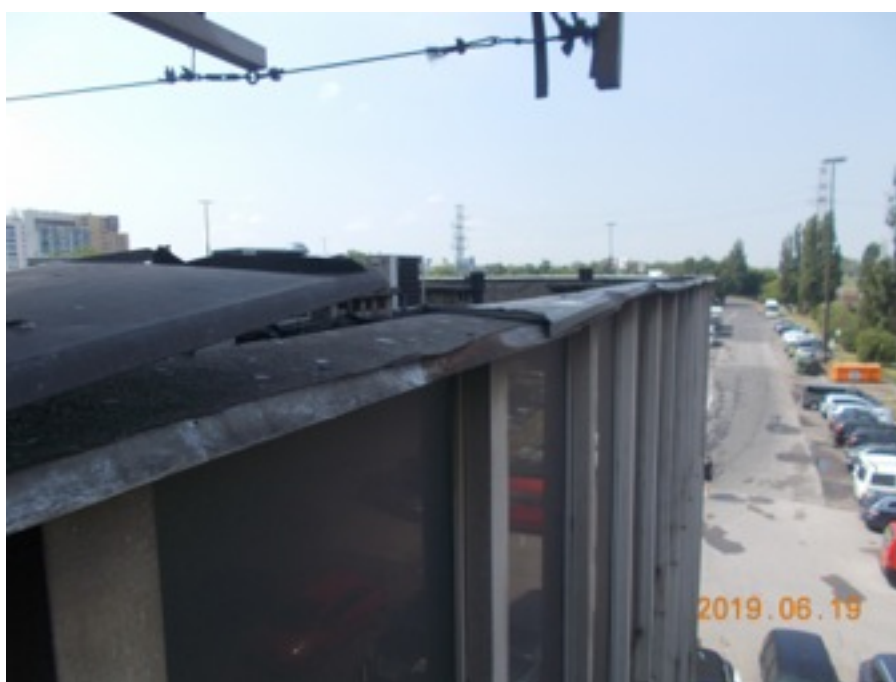
Zdjęcie Nr 157, 158 - brak fragmentu obróbki blacharskiej; ruchome, odkształcone obróbki blacharskie w zabudowie attyki - II p.
