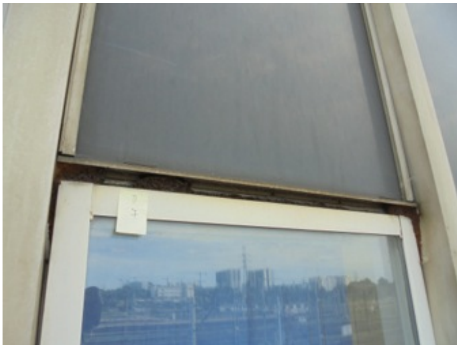
Zdjęcie Nr 36, 37 - brak łączników w listwie fasadowej; listwa podpierająca szybę wklejona na piankę montażową - I p.
