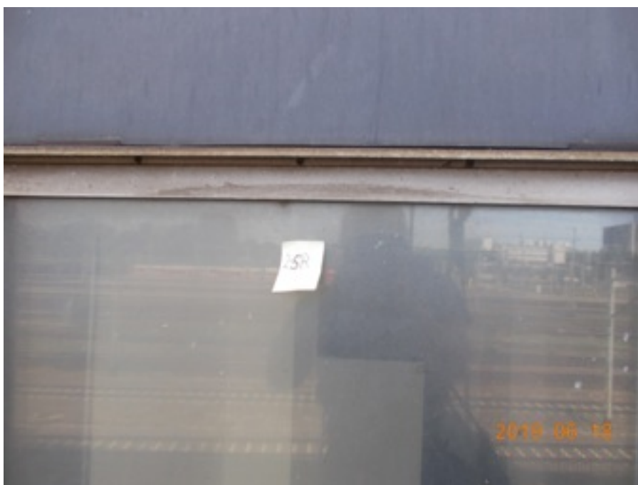
Zdjęcie Nr 111 - brak łączników w listwie fasadowej podpierającej szybę - I p.
