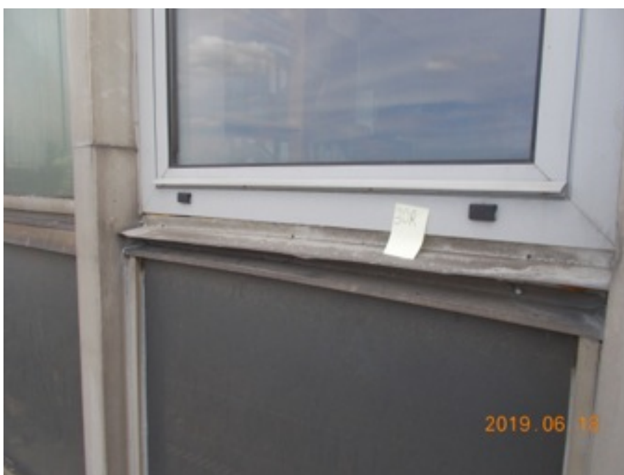
Zdjęcie Nr 117, 118, 119 - brak łączników w listwie fasadowej; listwa podpierająca szybę zablokowana wkrętem, listwa pod-parapetowa zamocowana tylko na skrajnych końcach, pozostawiono nie zaślepione otwory - IV p.
