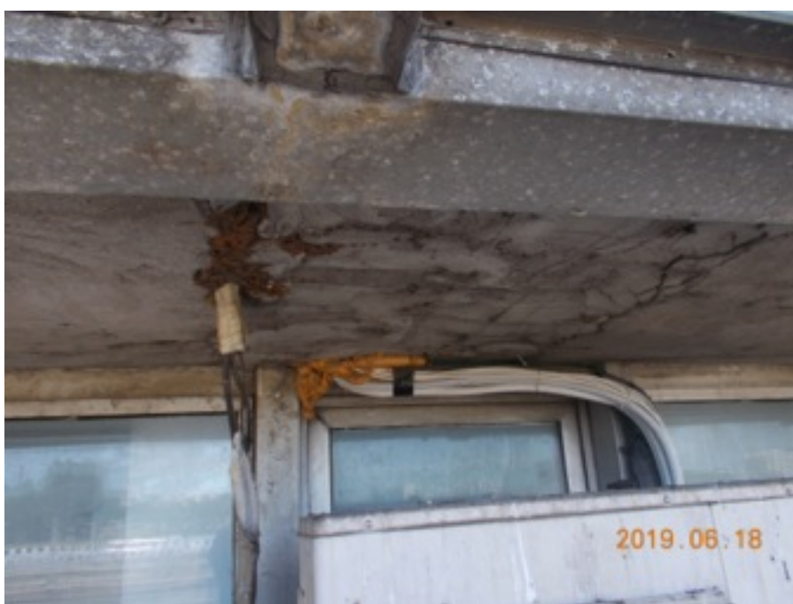
Zdjęcie Nr 93, 94 - popękany strop, odrywają się kawałki betonu - II p.
