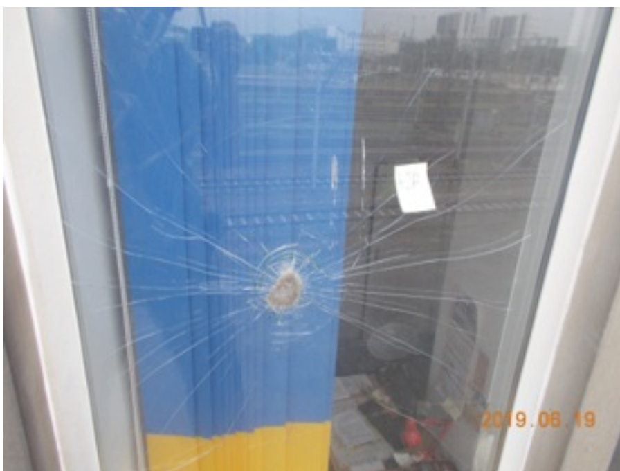
Zdjęcie Nr 140 - potłuczona szyba - I p.
