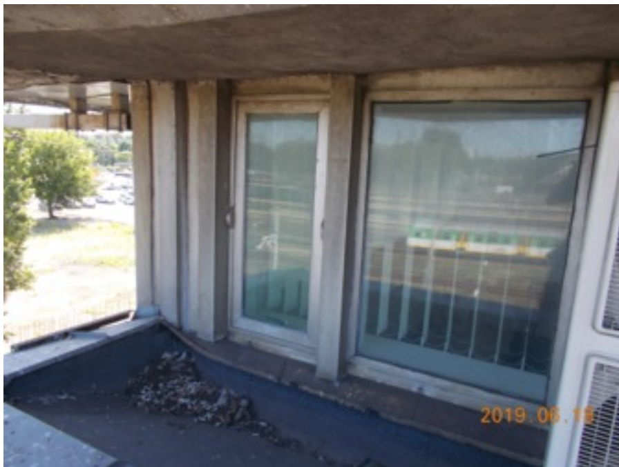
Zdjęcie Nr 70, 71 - wokół instalacji na II p. zalegają odchody ptasie
