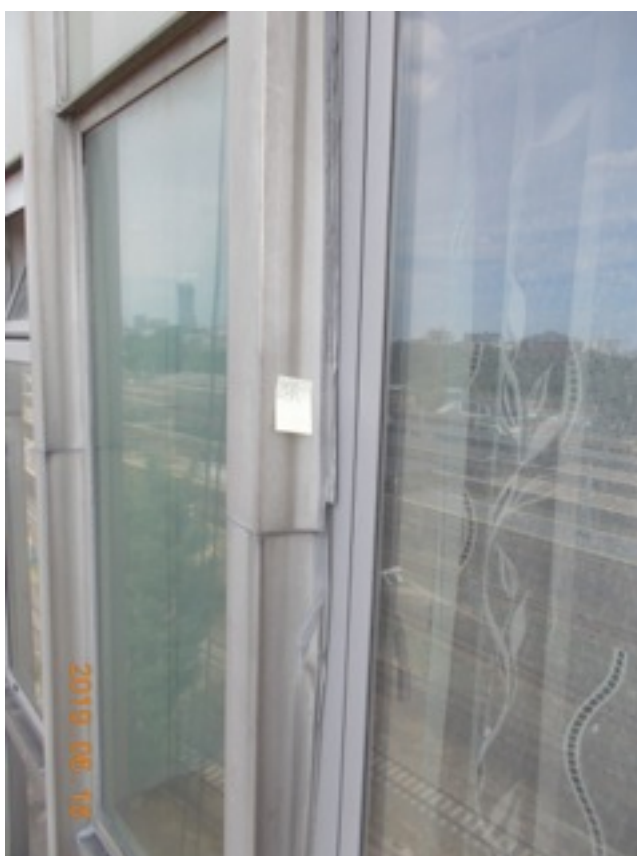
Zdjęcie Nr 115 - brak ciągłości fugi uszczelniającej - VI p.
