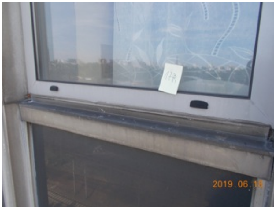
Zdjęcie Nr 99, 100, 101 - brak ciągłości fugi doszczelniającej - VII p.
