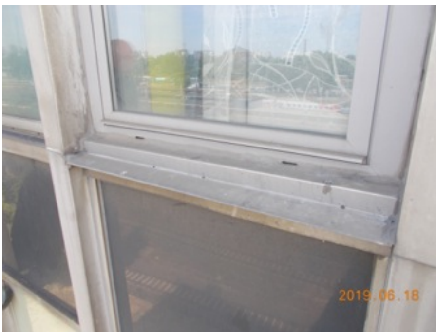
Zdjęcie Nr 103, 104, 105, 106 - brak podparcia szyby nieprzeziernej, brak profilu podpierającego szybę, brak ciągłości fugi - VI p.
