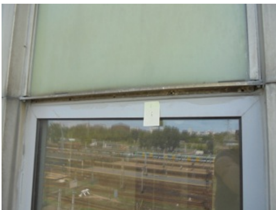
Zdjęcie Nr 21, 22 - brak łączników w listwie fasadowej; listwa wspiera się na wkręcie przymocowanym do słupa fasady, brak obróbek po wymianie okna - IVp.
