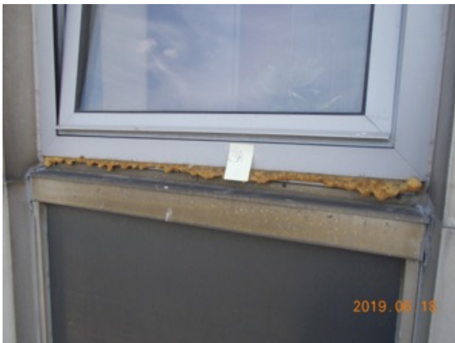
Zdjęcie Nr 108 - brak systemowych obróbek blacharskich - IV p.
